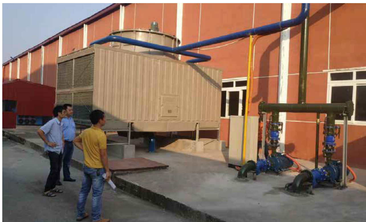
NHÀ MÁY DRAGOJET-KCN QUẾ VỖ BẮC NINH-APC-S-400
