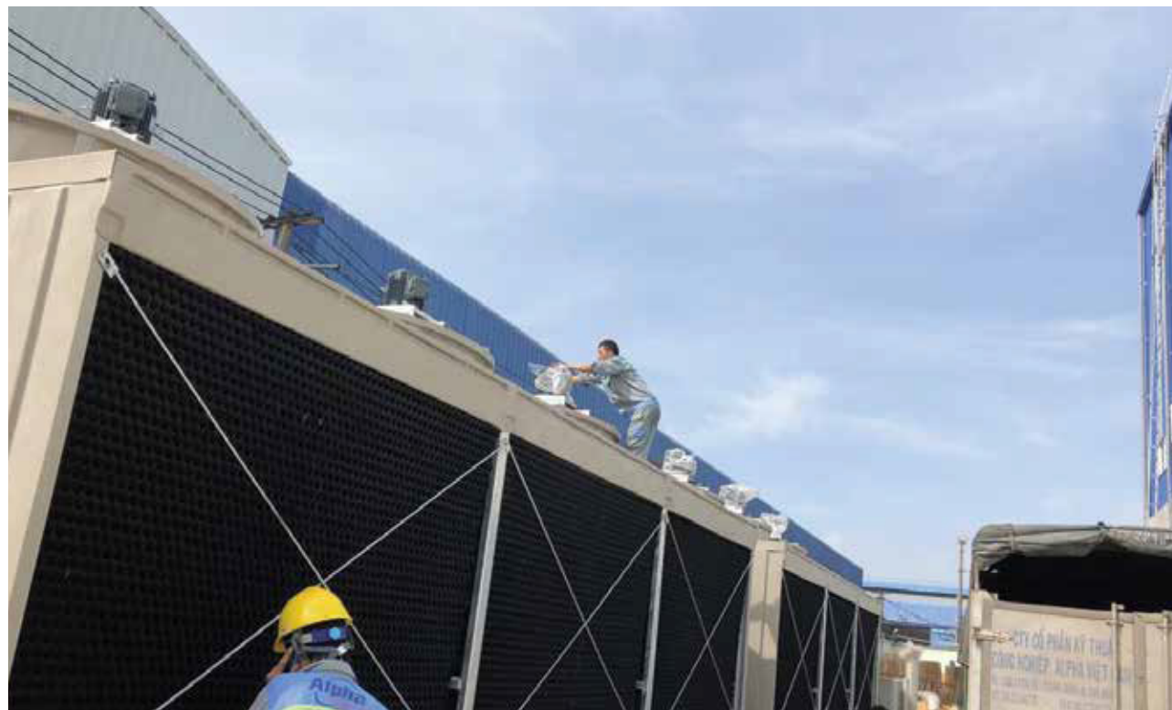
NHÀ MÁY DÂY CÁP ĐIỆN LS VINA HẢI PHÒNG - APC-S-1800DC6 (300x6)
