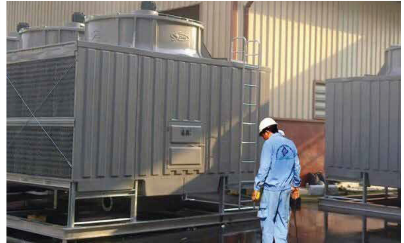
NHÀ MÁY HIANG KIES - KCN NHƠN TRẠCH, ĐỒNG NAI - STA-750SUN-DC2
