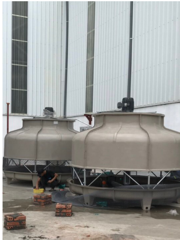
CÔNG TY GẠCH MEN TAKAO PHÚ THỌ APC-150 X 2
